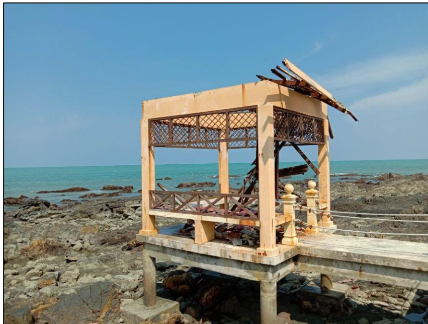
Foto 1: Keadaan pondok yang tidak selamat digunakan
