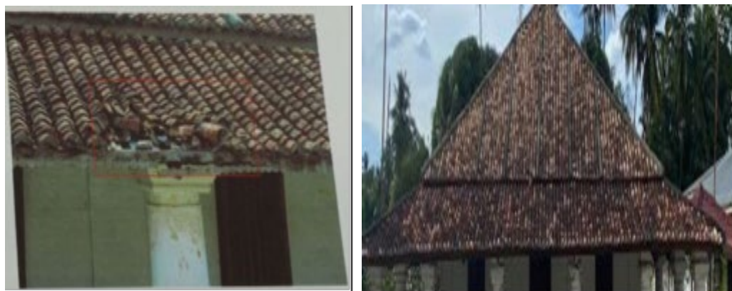
Rajah 6. Perabung yang reput (kiri) dan perabung yang telah dibaiki (kanan)
